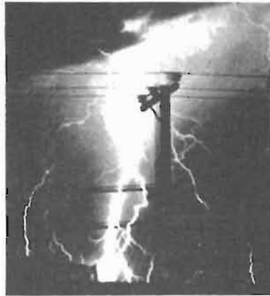
Fig. 3 - Un fulmine che cade molto vicino ad una linea a media tensione induce su essa dei potenziali elevati, che non arrecano danno, grazie alla presenza di scaricatori. Però gli «Spikes» ossia brevi impulsi ad alto voltaggio, che si propagano lungo la linea e proseguono per via capacitiva, oltre la cabina di trasformazione; arrivando in casa sulla rete a 220 V, sono in grado di danneggiare diodi ed altri semiconduttori dei nostri alimentatori.
